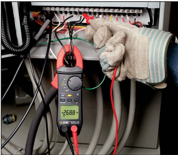
Modelo F05 supervisando voltios, amperios y potencia en un panel de control.
